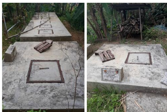
Gambar 2. Kondisi Aktual IPAL Komunal Kota Banjarbaru
