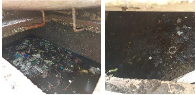
Gambar 3. Kondisi Aktual Bak Inlet dan Bak AF 1 IPAL Komunal
