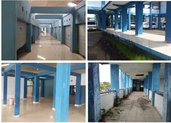
Gambar 1. Kondisi Fasilitas Terminal Sumber: Analisis Pribadi (2023)
